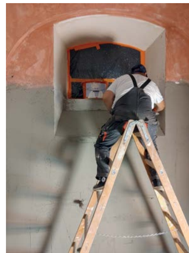
← Prace remontowe w budynku przy ulicy Myśliwieckiej 8. Fot. Archiwum Arembud Renovation works in the building at 8 Myśliwiecka Street. Photo Arembud Archive
