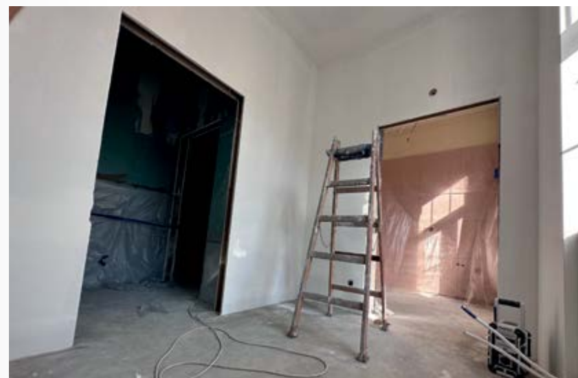
← Prace remontowe w budynkach Wydziału Sztuki Mediów przy ulicy Spokojnej 15. Fot. ASP w Warszawie Renovation works in the buildings of the Faculty of Media Art, 15 Spokojna Street. Photo ASP in Warsaw
